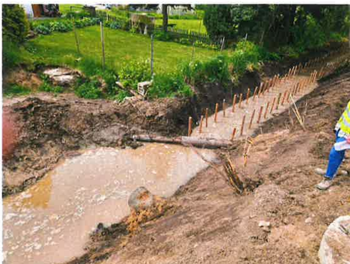
Zdjęcie nr 3. Awaria kanału kanalizacyjnego w miejscowości Oracze. Źródło: archiwum własne
