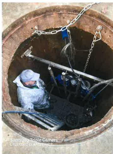
Rys. nr 6 przepompownia Chetchy po modernizacji (źródło własne)
