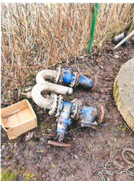
Rys. nr 5 Przepompownia Chetchy stare urządzenia. (źródło własne)
