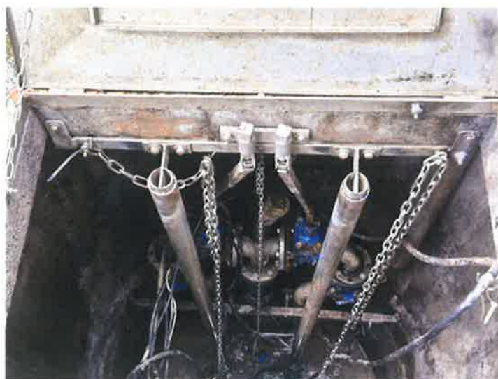
Rys. nr 4 Przepompownia Oracze po modernizacji (źródło własne)
